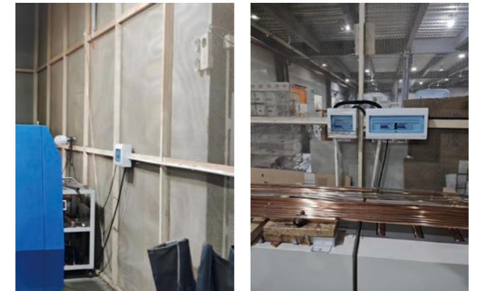
整改前：存在一闸多线情况
